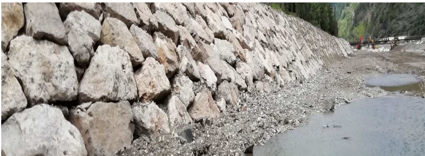
Veduta della massicciata realizzata da Veneto Acque a protezione del Lago di Alleghe (BL)
